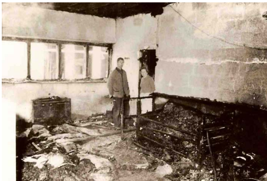
Feuer in der Pfarrkirche Karken durch Brandstiftung am 2. Oktober 1972
